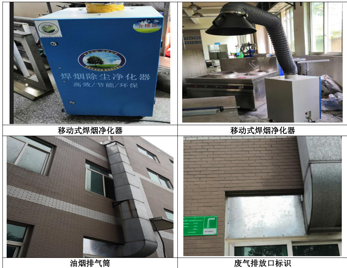
图3-2 废气治理措施现场照片
